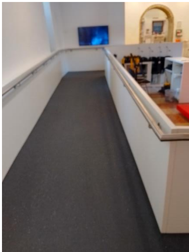
Rampe im Eingangsbereich
